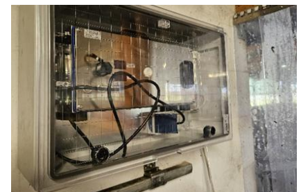
Installation der Gaschromatographen (Sniffer) im OG-Betrieb
