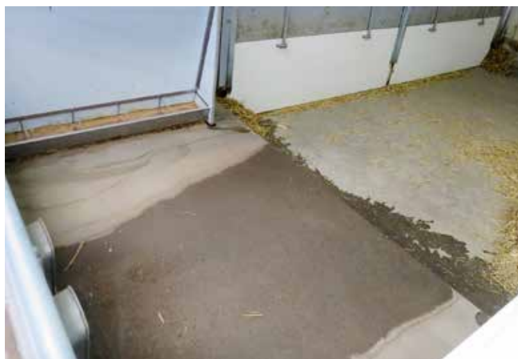
Baufehler mit Folgen: Fehlende Abflüsse führen zu ständig nassen Flächen.
