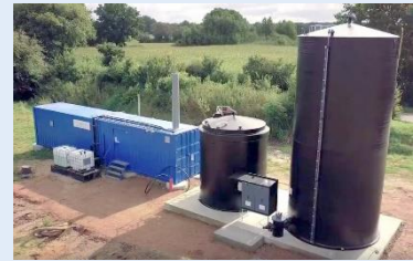
Bild 1: Aufbereitungsanlage (links), Schwefelsäure- (Mitte) und ASL-Lager (rechts)
